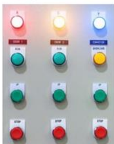
รูปที่ 2.11 ตัวอย่างไฟแสดงสถานะที่ติดตั้งอยู่บนตู้ควบคุมไฟฟ้า
